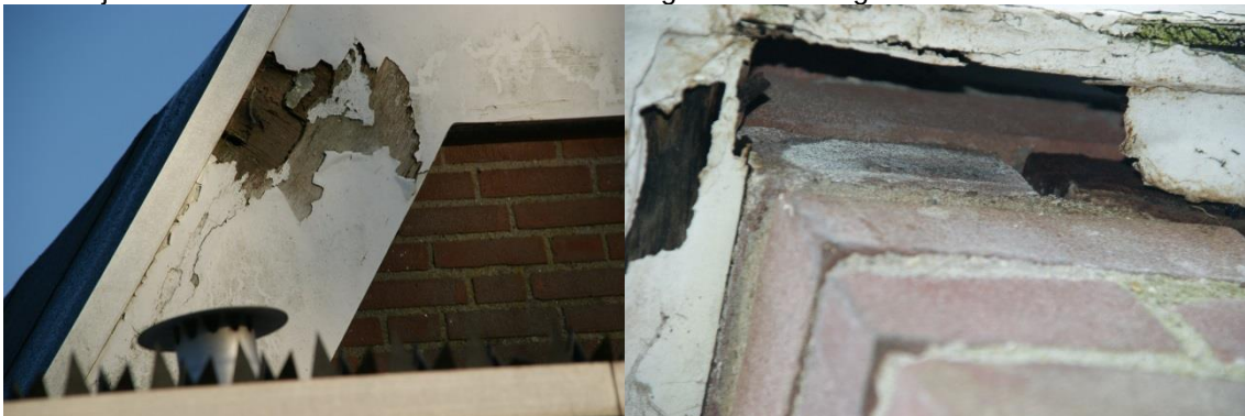
Figuur 3: gebouwdetails hout(rot)schade die toegang tot ruimtes achter de boorden/plinten geeft
