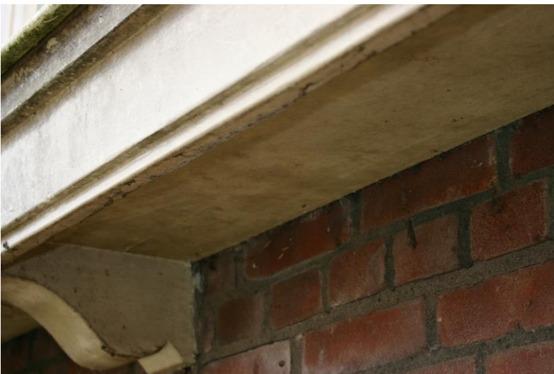
Figuur 4.2.4. Tussen de gootbetimmeringen en de gevels zijn nergens kieren aanwezig.
