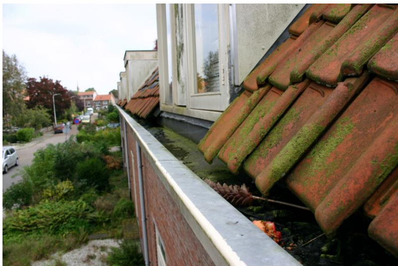
Figuur 4.2.1. Hier is onvoldoende ruimte voor vogelnesten.
