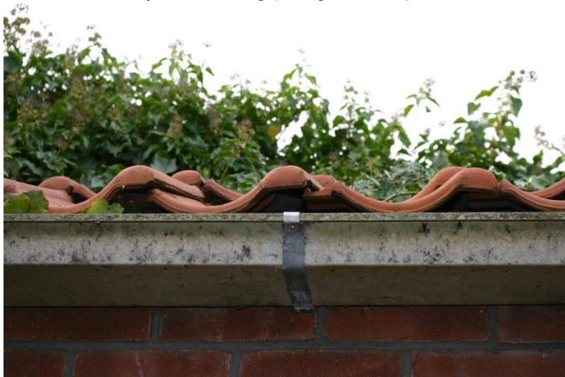
Figuur 4.2.6. De ruimte onder de dakpannen op de schuurtjes is te open voor vleermuizen en mussennesten zijn hier afwezig.
