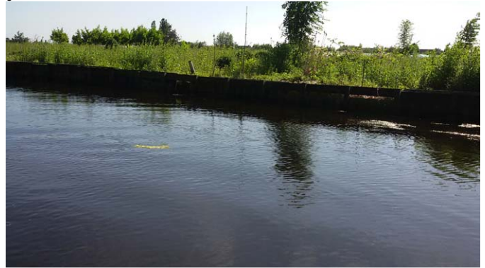
foto 02 - asbestverdacht object MV01
