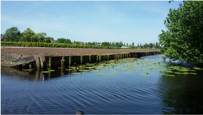
foto 09 - asbestverdacht object MV04
