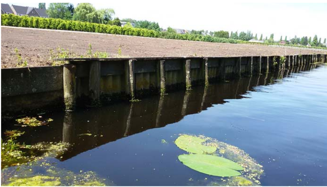
foto 11 - asbestverdacht object MV04
