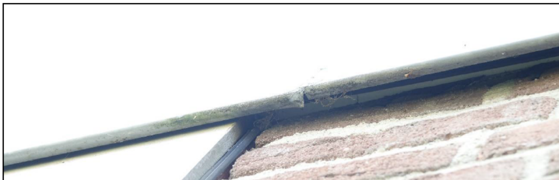
Figuur 10: De ruimte onder de aluminium daklijsten bedraagt slechts zo'n vier centimeter, waardoor hier geen constant microklimaat kan ontstaan. Dit maakt de daklijst ongeschikt als verblijfplaats.
