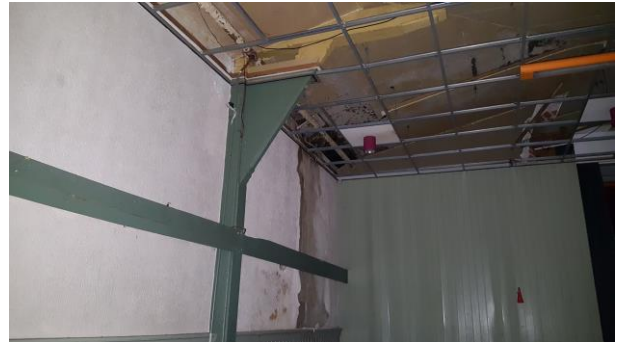
Fragment plafond zaal
