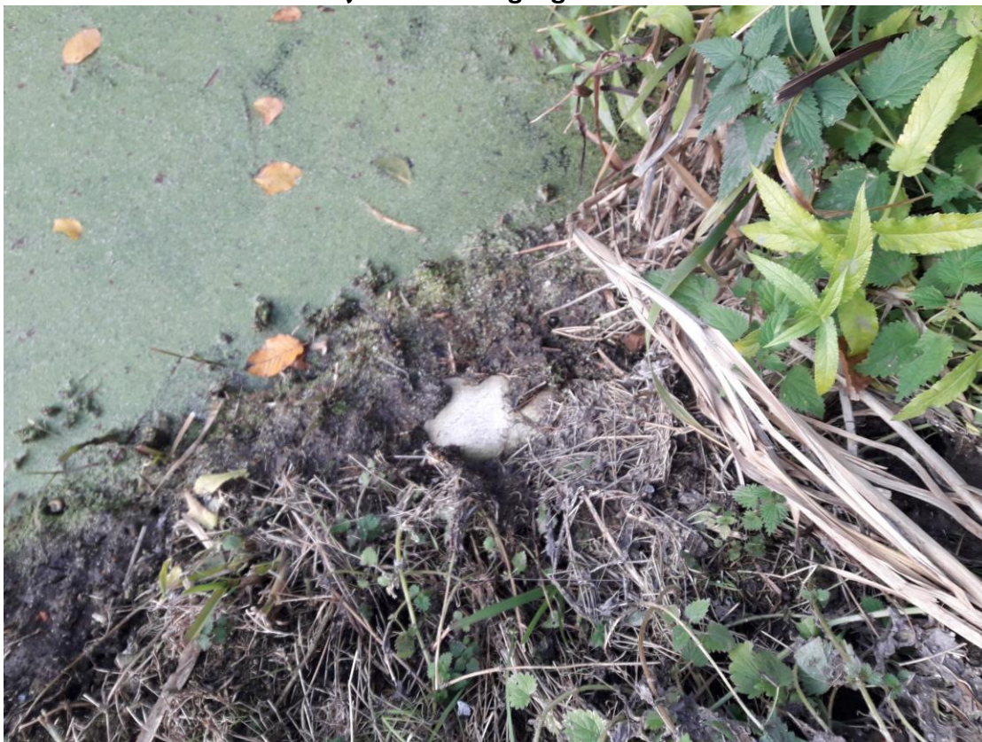
Asbestverdacht materiaal bij oever watergang
