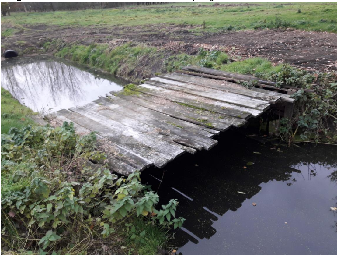
Brug en asbestverdacht materiaal in bodem bij brug
