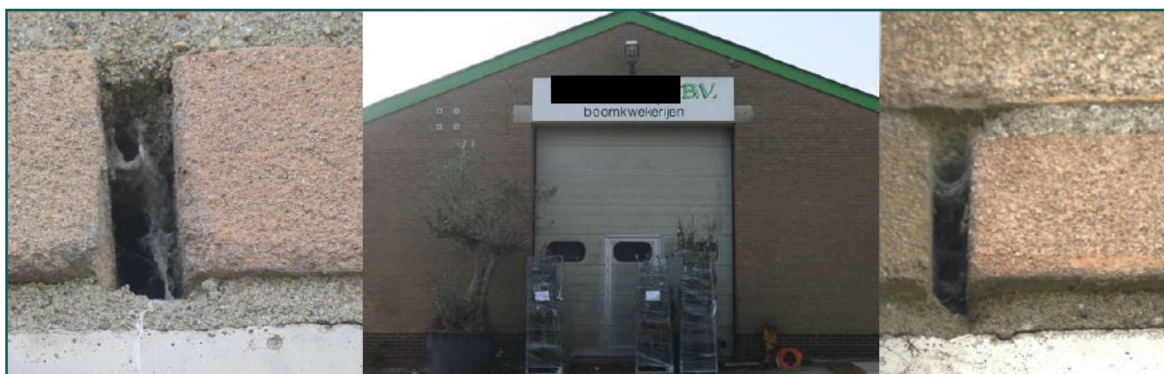
Figuur 3.2 Links: in de linkerstootvoeg is spinrag aanwezig. Midden: de voorgevel met lamp. Rechts: in de rechter stootvoeg is spinrag aanwezig. De foto's in dit figuur zijn genomen op 10 oktober 2023.
