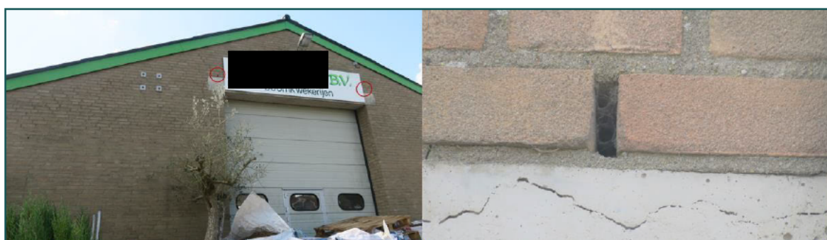
Figuur 3.1 In het gehele kantoorpand zijn twee stootvoegen aanwezig (links, aangegeven met de rode cirkels). In de stootvoegen zijn spinnenwebben aanwezig (rechts). De foto's in dit figuur zijn genomen op 26 april 2022.
