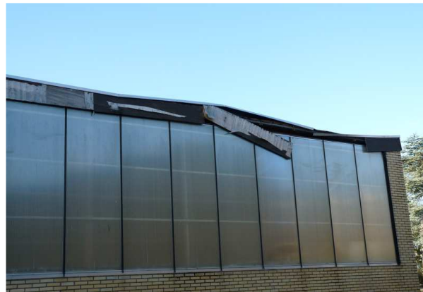
Figuur 13. Losliggende dakrand aan de oostkant van de loods op het noordwestelijk deel van het plangebied
