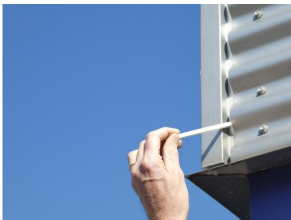
Figuur 21 Ruimte tussen golfplaten
