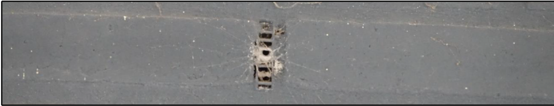
Figuur 14: Een klein deel van de stootvoegen is afgesloten met bijenbekjes en/of spinnenwebben.
