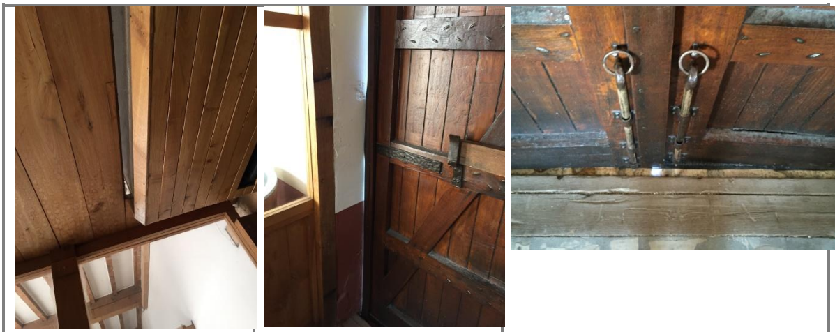
Figuur B.4 Binnenzijde feestzaal het Atrium ; hoofdentree met voorportaal met kierende geveldelen
