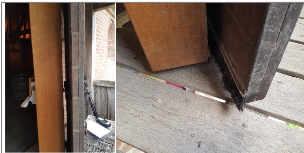
Figuur A.5 Nooddeur; dubbele houten deur voorzien van borstel aan de onderzijde
