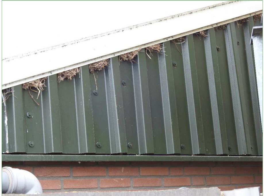
De achterzijde van de vierkante varkensstal, duidelijk zichtbaar is het nestmateriaal (Spreeuw) wat uitsteekt tussen de openingen van de staalplaten en de dakrand.
